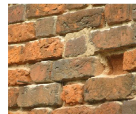
Wykwity i degradacja zapraw do skutku nieodporności zapraw wapiennych w warunkach zewnętrznych.
