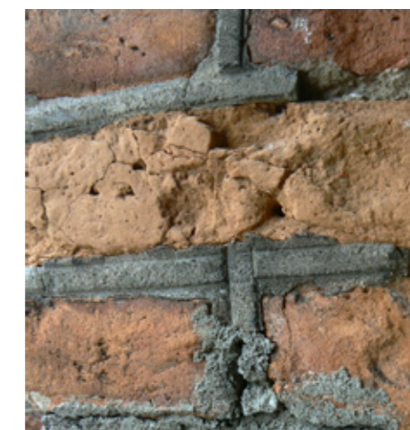
Degradacja lica cegieł przez bardzo mocne i szczelne zaprawy z cementem.
