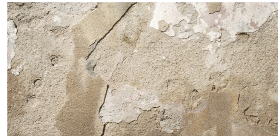
Degradacja zbyt słabego tynku „czysto-wapiennego” w warunkach zewnętrznych.
