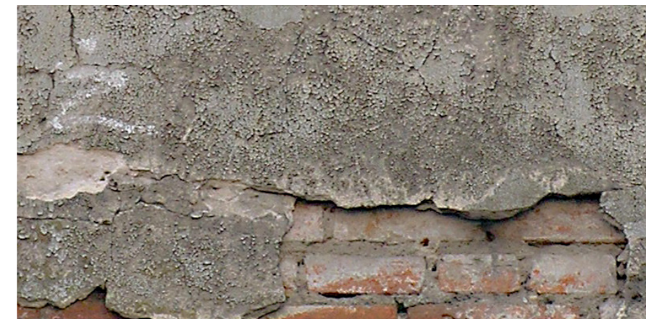
Spękania i rozwarstwienie zbyt mocnego tynku cementowego na słabszym podłożu.
